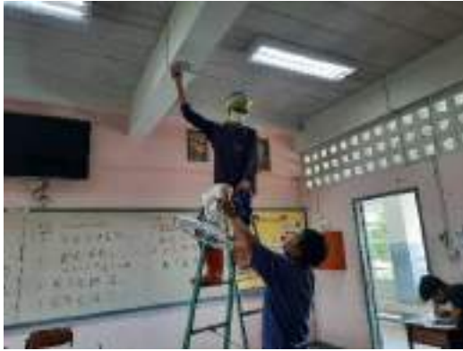
ครุภัณฑ์เครื่องปรับอากาศ 1 เครื่อง
